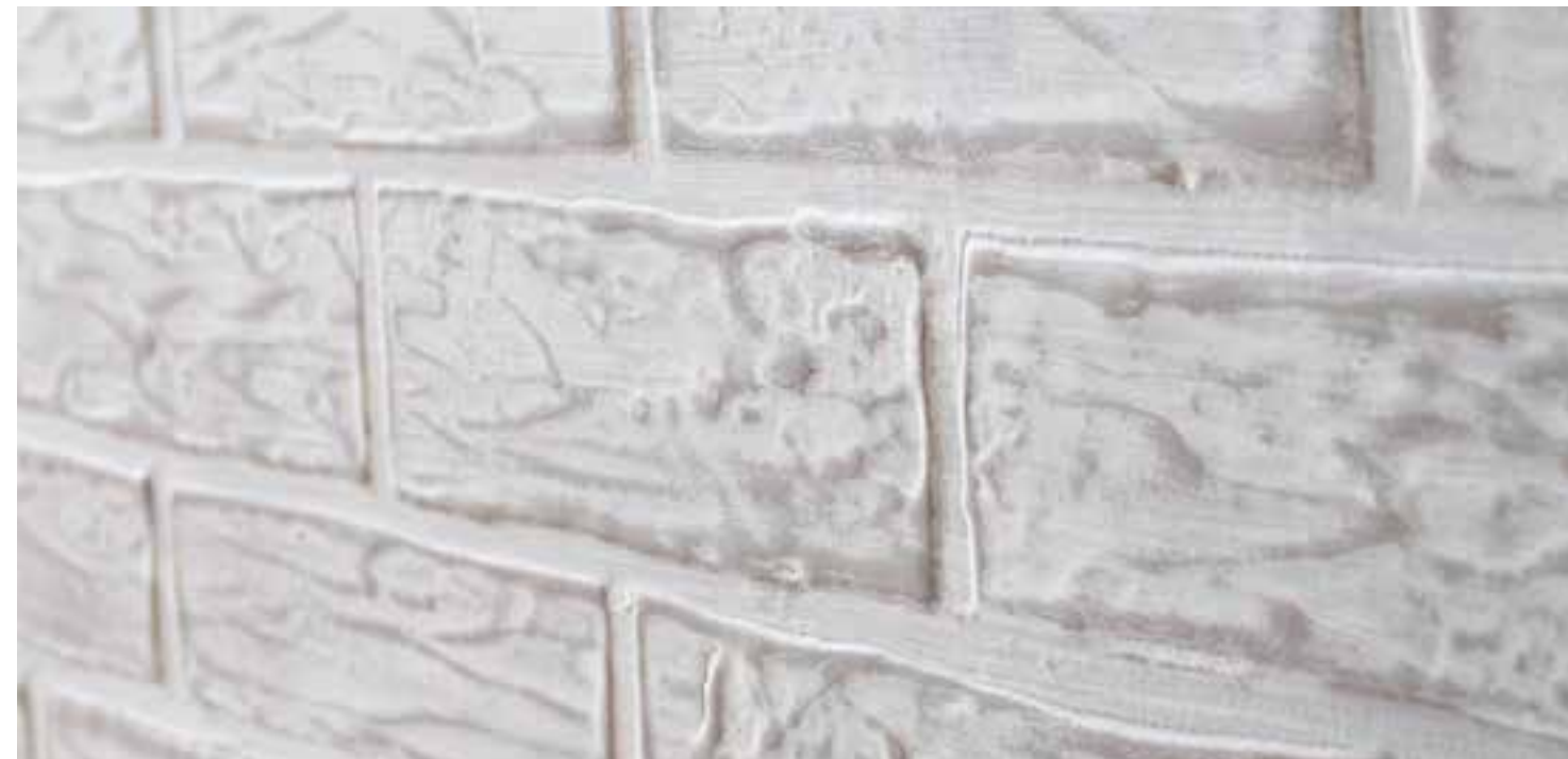
dettaglio detail détail
